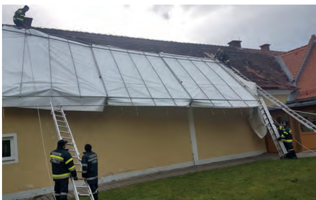
Unwetterschaden beim Pfarrheim 13.05.2019 19.10 Uhr
